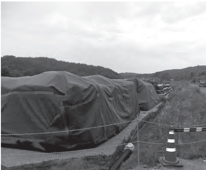
▲仮置き場の不足が懸念される除染現場
