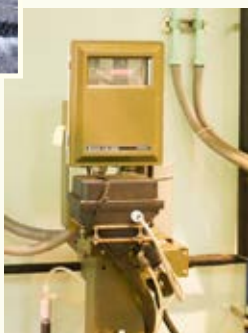
浄水場の取水口に設置された「濁度計」と呼ばれる装置。濁った水の流入を防ぎます
