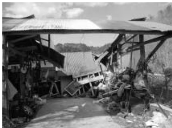
▲行き場のない解体除染物
