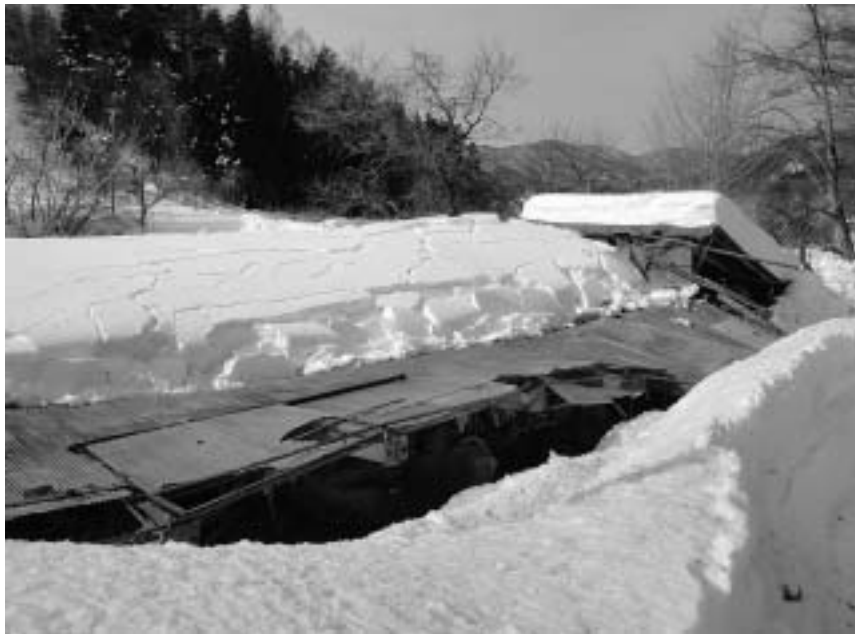
▲倒壊した鉄骨造ハウス
