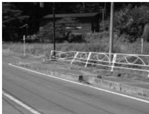
▲除雪で壊れた縁石とガードパイプ
