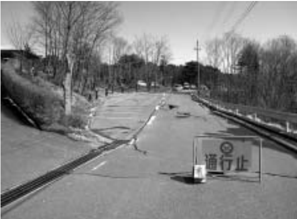
▲地震の被害を受けた道路（宿泊体験館きこり前）
