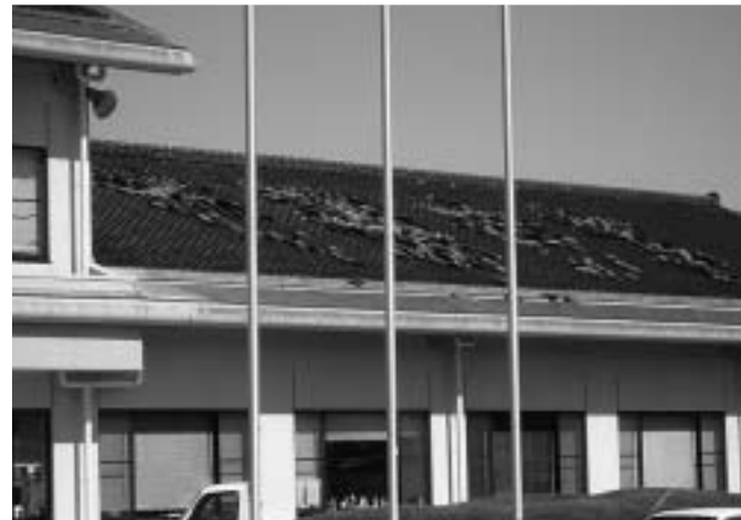
▲役場庁舎の屋根も被害を受けました
