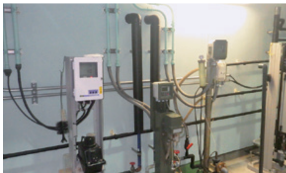
原水の濁りをリアルタイムで測定しきれいな水のみ浄水。
