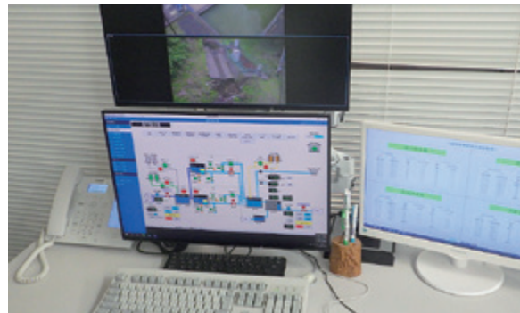
監視装置により浄水場の状況を管理しています。
