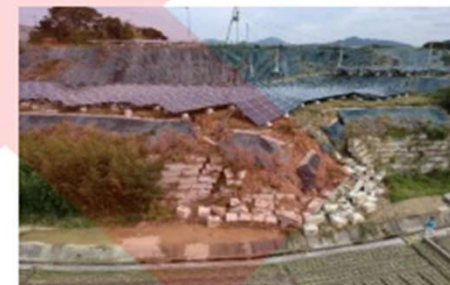
法面保護工が崩れて流出した事例
