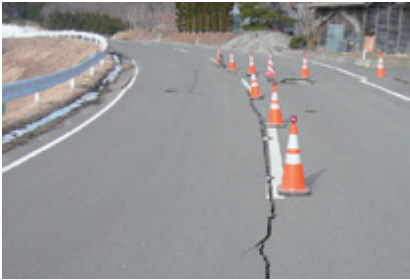
村職員が被害状況を見回り危険箇所には通行止めなどの対策を実施。
