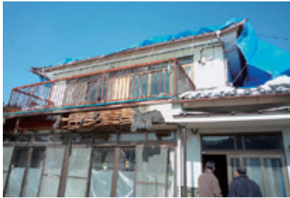
民家でも外壁の損傷や屋根瓦の落下などが相次ぎました。
