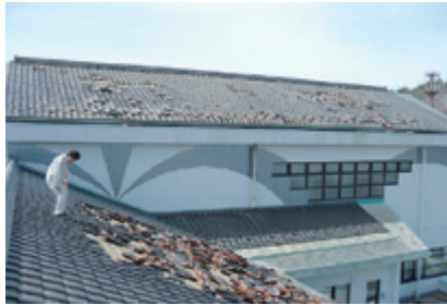
地震によって屋根瓦が壊れた村役場。庁内書類などが散乱しました。
