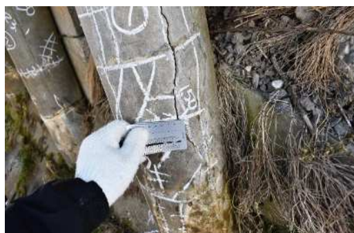
77. 八和木一ノ関1号橋：RCπ桁橋 (橋長：3.80m、1970年竣工) 下部工の遊離石灰を伴ったひびわれ ※著しいひびわれにより、鉛直支持機能の低下が推測される。 (迂回路有り)
