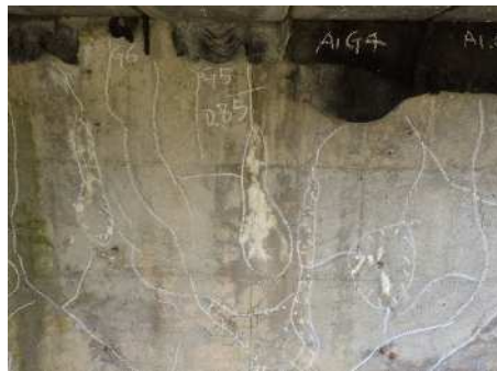
86. 草野車1号橋：プレテン床版橋 (橋長：12.50m、1972年竣工) 下部工の遊離石灰を伴ったひびわれ ※水の浸入により、内部鉄筋の腐食が進行する可能性が高い。 (迂回路有り)
