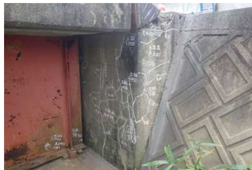
20. 大橋：鋼I桁橋 (橋長：31.60m、1976年竣工) 下部工の遊離石灰を伴ったひびわれ ※ひびわれからの雨水の浸入により、内部 鉄筋の腐食が進行する可能性が高い。 (迂回路有り)
