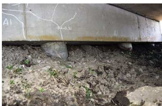
97. 笹ノ沢1号橋：RC床版橋 (橋長：4.00m、1972年竣工) 下部工基礎部の土砂流出 ※基礎部の土砂の流出により、橋台背面土砂の沈下が進行する可能性がある。 (迂回路有り)
