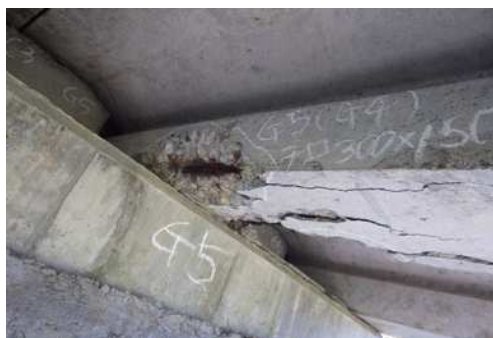
74. 松窪1号橋：プレテンT桁橋 (橋長：13.06m、1968年竣工) 主桁下面及び側面のひびわれ、 鉄筋露出・うき ※露出鋼材の著しい腐食により耐荷力の低下が推測される。(迂回路有り)
