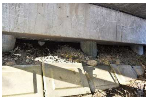
102. 笹ノ沢2号橋：RC床版橋 (橋長：4.00m、1972年竣工) 下部工基礎部の土砂流出 ※基礎部の土砂の流出により、橋台背面土砂の沈下が進行する可能性がある。 (迂回路有り)
