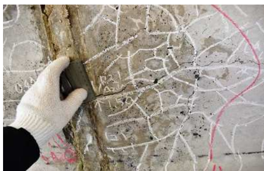
68. 山田1号橋：ボックスカルバート橋 (橋長：3.48m、1995年竣工) 頂版下面及びハンチ部のひびわれ ※多数のひびわれの発生により、耐荷力の低下が推測される。(迂回路有り)
