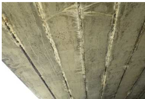
67. 妻ノ橋沼ノ江1号橋：プレテン床版橋 (橋長：13.60m、1969年竣工) プレテン桁間詰部の錆汁を伴った遊離石灰 ※内部鋼材の腐食の進行は、耐荷力の低下 に影響する。(迂回路有り)
