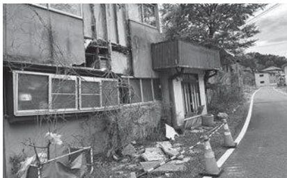
▲保安上危険となりえる状態の空き家
