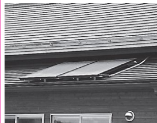
▲④太陽光発電と太陽熱温水パネルで太陽エネルギーを有効活用します。
