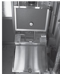
▲②新ボイラー：お湯を不凍液に熱交換して床下を循環させています。
