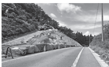
▲災害で崩れた峠道
