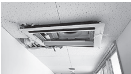
▲きこりの被害状況
