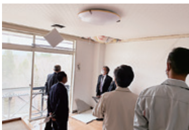
▲現地での被害状況確認の様子
