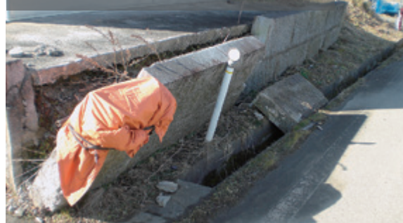
塀の倒壊等の被害が確認されています
