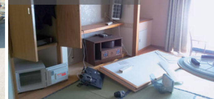
宿泊体験館きこりの宿泊棟の被害
