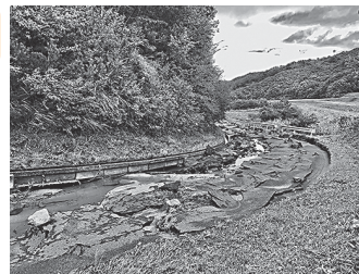
▲台風で被害にあった道路
