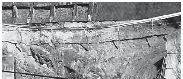
▲台風19号による道路崩落
