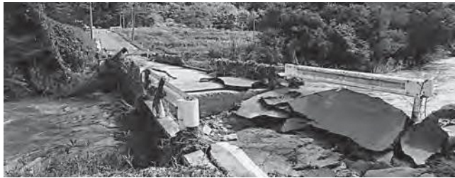
▲台風による被害の状況
