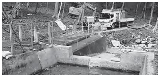
▲台風19号により被害を受けた水道施設
