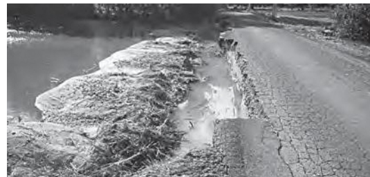
▲台風による被害の状況
