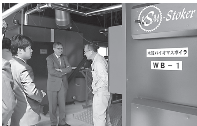
▲いたてホームに導入されたチップボイラー
